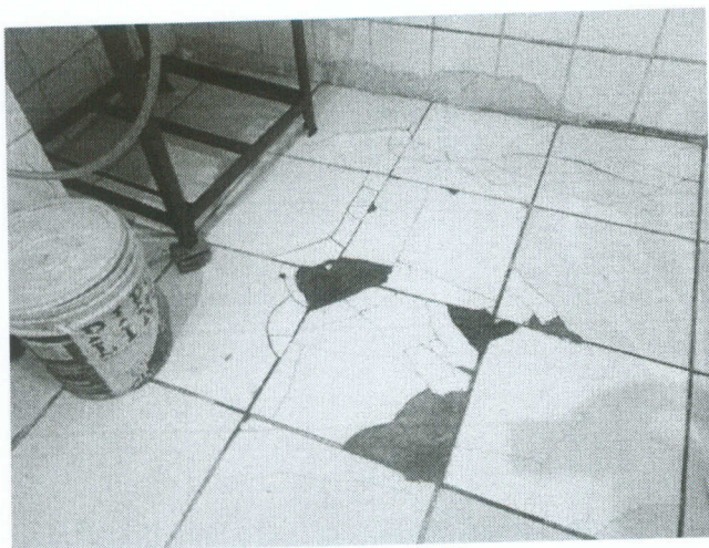
Creche Sonho Infantil 1 (afundamento do piso)
