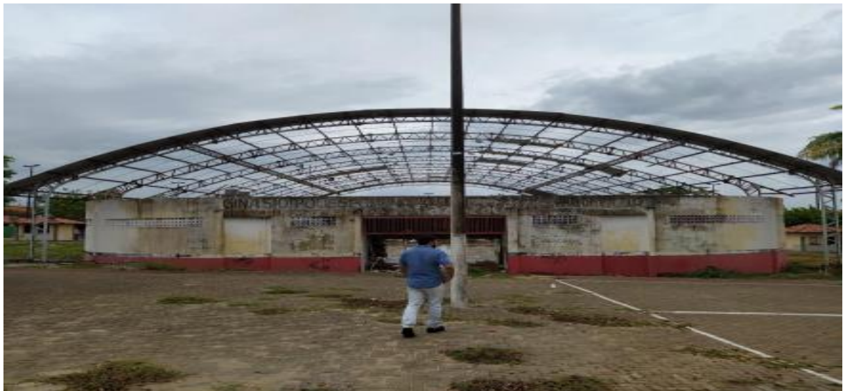
Figura 1: Detalhe do Ginásio com a cobertura deteriorada, verificado em visita técnica.
